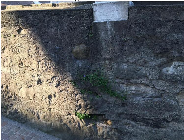
Abbildung 3: Biogener Befall, zurückgewitterte Sandsteine und rissiger Zementputz.
