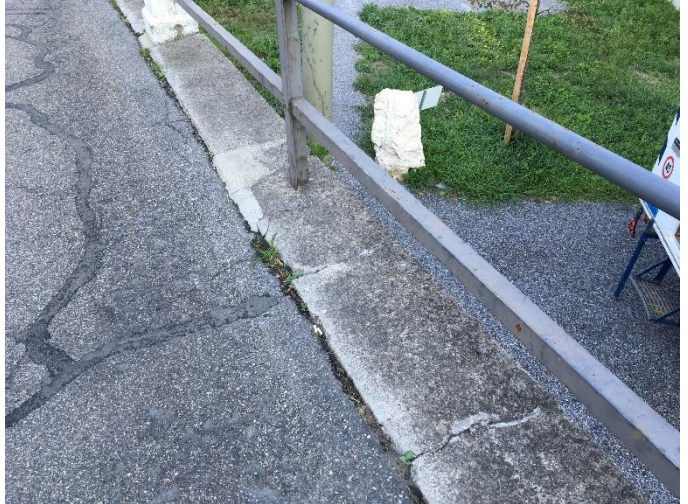
Abbildung 4: Risse in der Mauerkrone.
