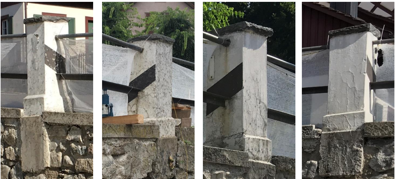
Abbildung 16-19: Zustand der Pilaster vor der Instandsetzung.
