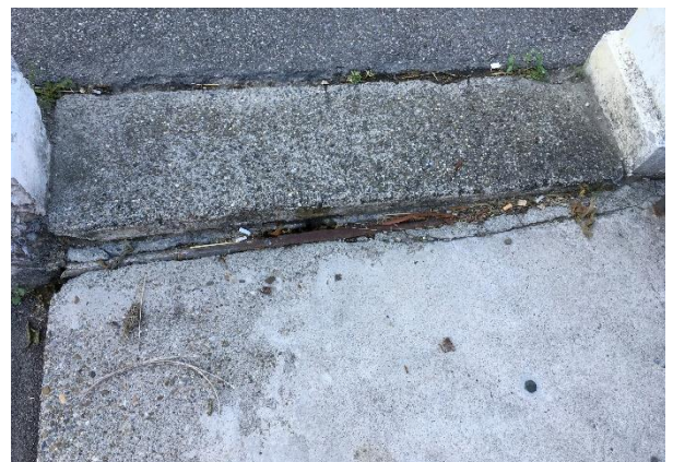
Abbildung 14: Marode Stufe beim Treppenaufgang
