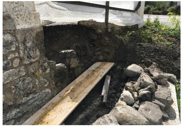
Abbildung 15: Zusammengefallenes Mauerwerk, dahinter, kein Mauerwerk mehr vorhanden.
