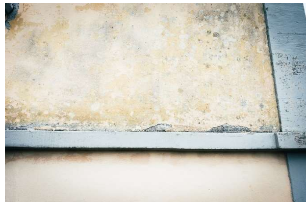
Verputzabplatzungen über dem Gurtgesims
