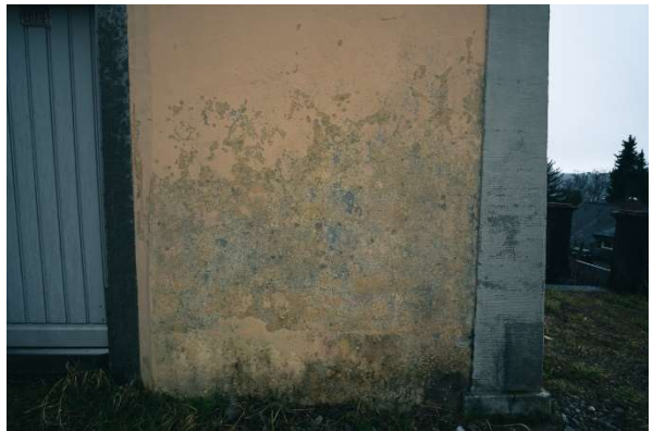
Anstrichabplatzungen und biogener Bewuchs an der Westfassade
