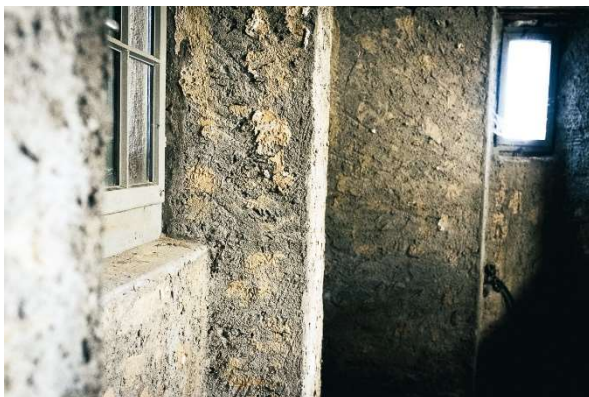
Zementputz mit Kleberrückstände auf der Innenseite unteres Geschoss
