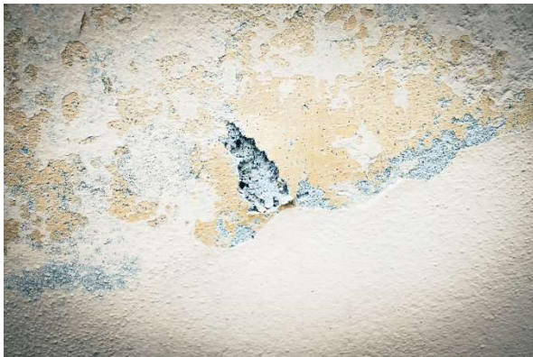
Anstrich- und Verputzabplatzungen über Putzreparaturstellen, darunter die ältere Oberfläche
