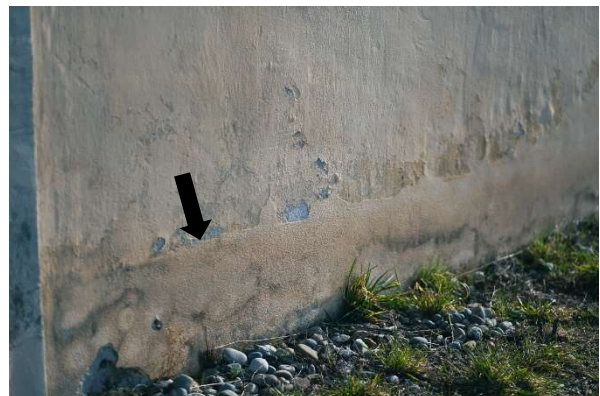
Verfärbungen, Abplatzungen und Reparaturstellen im Sockelbereich der Südfassade
