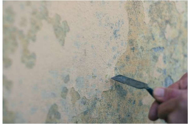
Grossflächige Abplatzungen des oberen Anstriches und biogener Bewuchs an der Westfassade, darunter ist der ältere Anstrich erkennbar
