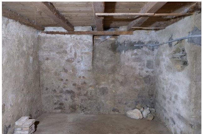
Bild 15: Feuchte Stellen und Ausblühungen im Keller
